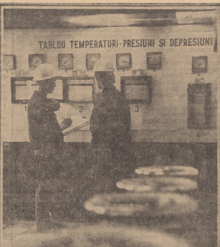
Panoul de comandă și de urmărire a parametrilor funcționali la instalația de rafinare termică a zincului
