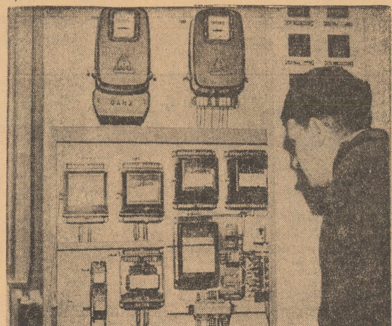
În zilele noastre în toate ramurile industriale procesele tehnologice sint în bună parte automatizate. — În fotografie: instalații de automatizare la cuplul electric cu arc, de 3 tone, din noua oțelărie de la „Independența II” Sibiu
