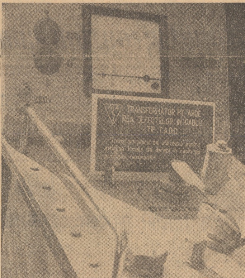
În gama variată a aparatelor electrice realizate de I.R.E. Sibiu în ultima perioadă se include și transformatorul pentru arderea defectelor în cabluri, tip T.A.D.C., funcționând pe principiul rezonanței.
