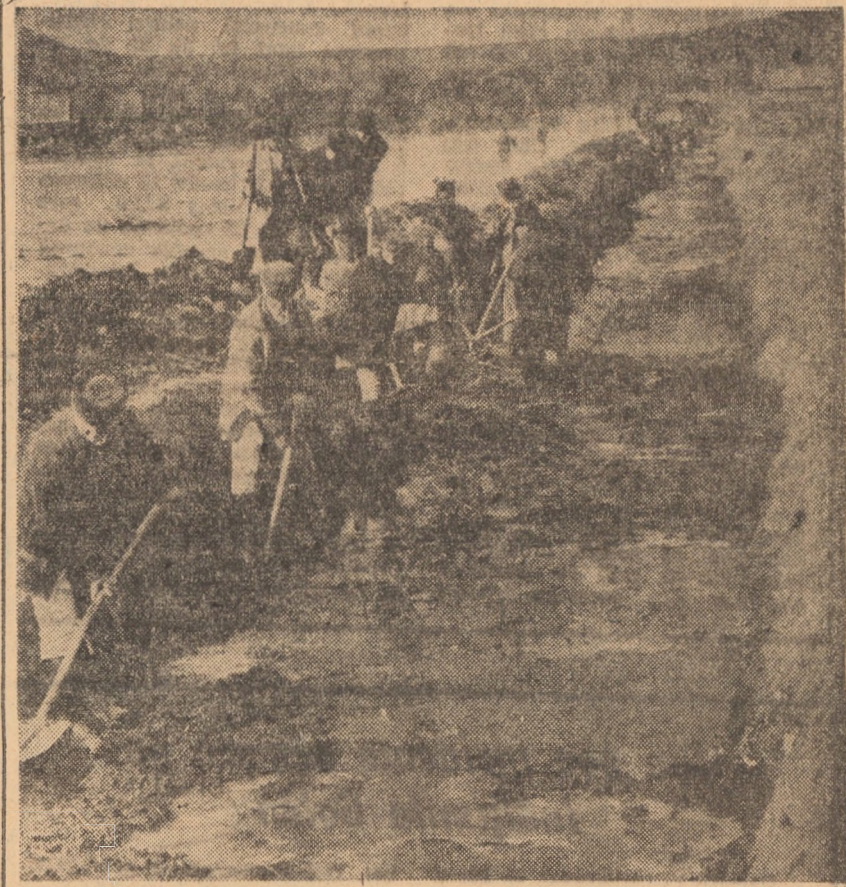
În „Lunci” la Alămor, țăranii cooperatori execută lucrări de decolmarea a canalelor de desecare. S-a executat această lucrare pe 550 m 2 din 1.500 planificați. În fotografie: aspect din timpul lucrărilor
