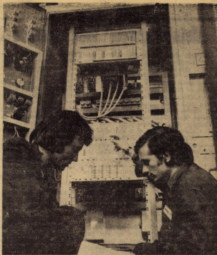
Pe linia modernizării continue a tehnologiilor de fabricație, la Întreprinderea mecanică Sibiu a intrat în funcțiune o nouă hală de tratamente termochimice. Secvența fotografică prezintă panoul de comandă al ultramodernei instalații de ioniturare
