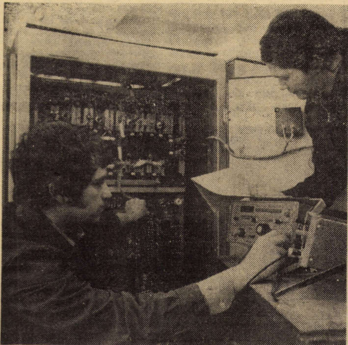
Depanarea invertorului de 2,5 KVA din cadrul instalațiilor dispecerului energetic de la I.R.E. Sibiu Foto: FR. NUSS
