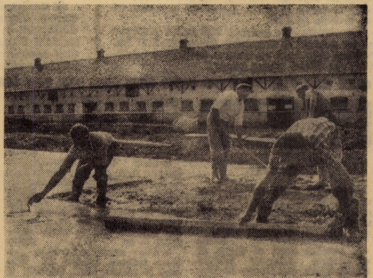
În aceste zile, la C.A.P. Cristian, o echipă condusă de Samuel Rill, aparținînd Grupului industrial de șantier Sibiu — întreprindere patronatoare a acestei unități — lucrează la turnarea unei platforme din beton la intrarea în camerele de furajare. Pînă în prezent a fost finalizată o suprafață de peste 250 metri pătrați Foto: FR. NUSS
