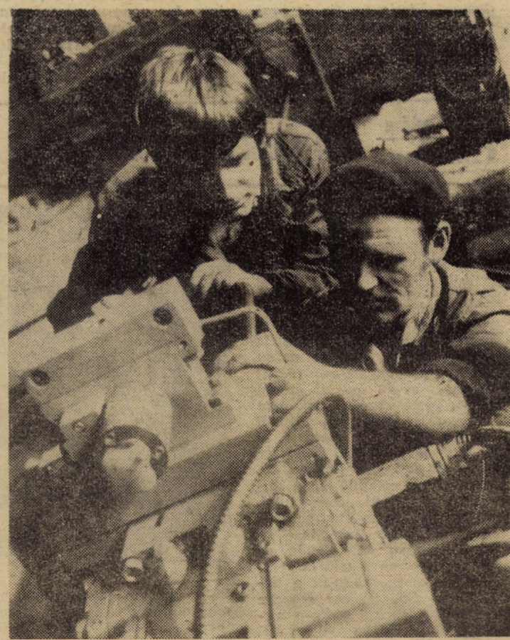
Activînd în secția mecanic șef al Întreprinderii de piese auto Sibiu, lăcătușii-mecanici Aron Șoaită și Gheorghe Gibaru execută lucrări de reparații de bună calitate la utilajele hidraulice din secțiile productive Foto: FRED NUSS
