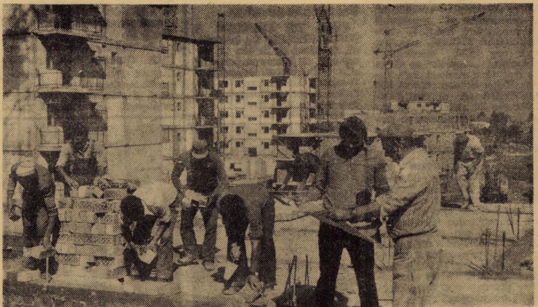
Pe șantierul „Valea Aurie” din Sibiu, prin hărnicia constructorilor prind contur noi și noi blocuri. Printre echipele de dulgheri și zidari ale căror rezultate merită a fi amintite se numără și cea condusă de maistrul Matei Eckenreiter care în acest an a predat 170 apartamente nefinisate. Iată-i, în fotografie, lucrînd la ridicarea blocului nr. 19.
