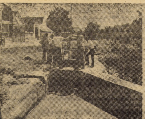
Microhidrocentralea electrică de pe riul Săliștea
