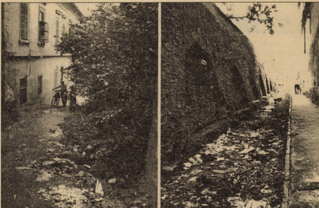
Am mai publicat imagini critice ale acestui loc dosnic, aflat în prelungirea străzii Manejului din Sibiu. Pasajul de-a lungul zidului, incluzînd și Turnul Bărbierilor, cîndva un refugiu al îndrăgostiților, se prezintă azi într-o stare deplorabilă, de nedescris. Gunoaiele, în cantități alarmante, aruncate anapoda de către niște iresponsabili, sporesc pe zi ce trece, devenind, în afara inesteticii și un veritabil focar de infecții. Spre edificare, facem o invitație edililor de a parcurge, măcar odată, acest pasaj și poate astfel să fie „măturată” în sfîrșit rușinea ce apasă acest loc.
