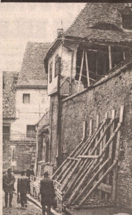
În imagine: Prăbușirea plafonului și a unor pereți ai apartamentului situat deasupra "Butoiului de aur" precum și deteriorarea zidului de pe Pasajul scârilor. Foto: Fred NUSS
